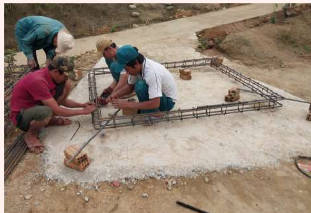
Người dân trong làng cùng chung tay thi công các hạng mục
